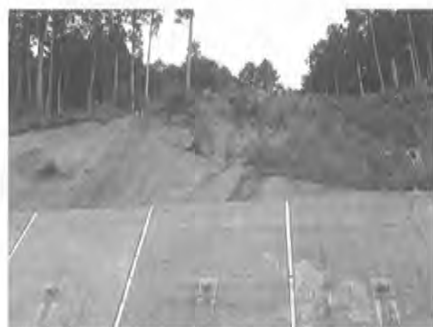
b) 吹き付けコンクリートの亀裂
