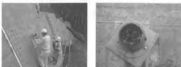
写真-3 アンカーの変状状況 (A1-13アンカー)
