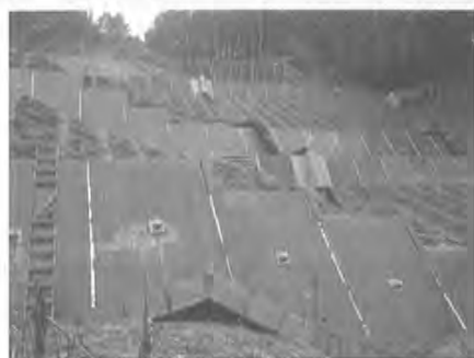
a) U字水路の変状と全景
