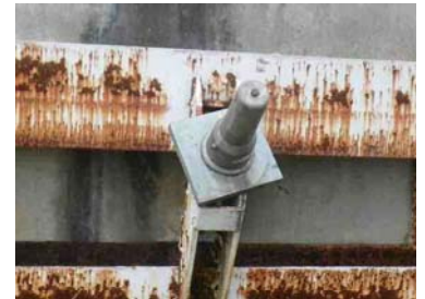
写真3. 支圧板が回転したアンカー
