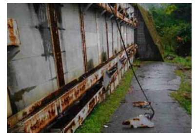
写真2. アンカーの飛び出し
