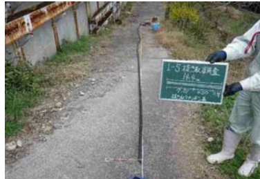
写真5. 破断アンカーL=14.4m
