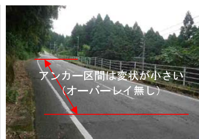
写真8. アンカー区間の道路状況
