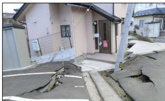
写真-1 液状化被害状況
